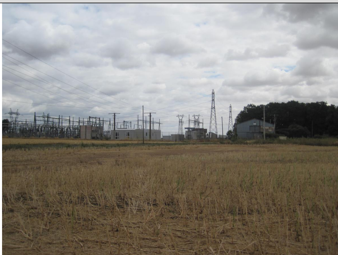
Cliché n°4 – vue depuis le nord-est – transformateur électrique
